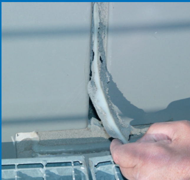
Eine Fugenabdichtung nach zirka drei Jahren. Die Abdichtung erfolgte hier mit Kompribändern. Durch Silikonnachbesserungen versuchte man zwischenzeitlich die Dichtigkeit wieder herzustellen.
